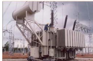
Lắp đặt điện thế 250MVA - 220/110 KV trạm điện Long Thành Nhà máy sơn ICI- Mỹ Phước -Bình Dương
